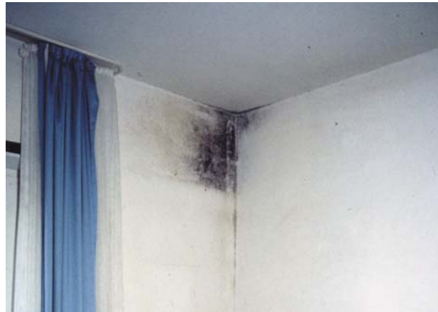
An einer durch Wärmebrückenwirkung eines Betonsturzes ausgekühlten Wandfläche schlägt sich Feuchtigkeit nieder. Der Schimmelpilz hat ideale Bedingungen für sein Wachstum
